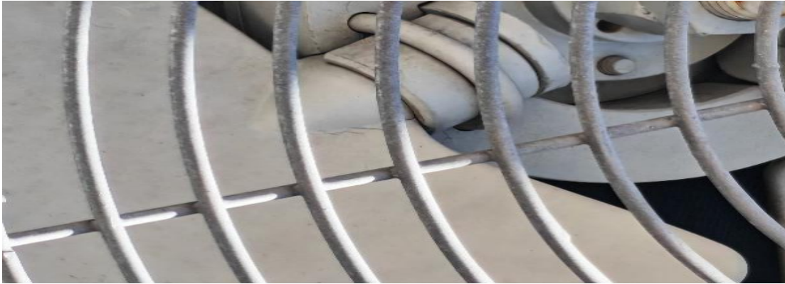
图 1 叶片开裂情况
